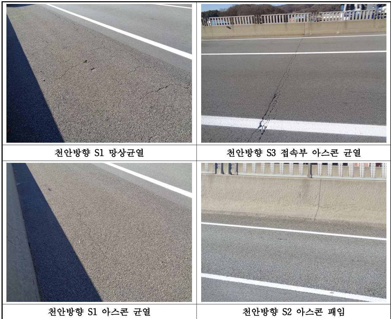
【사진 3.20】 교면포장 손상현황
