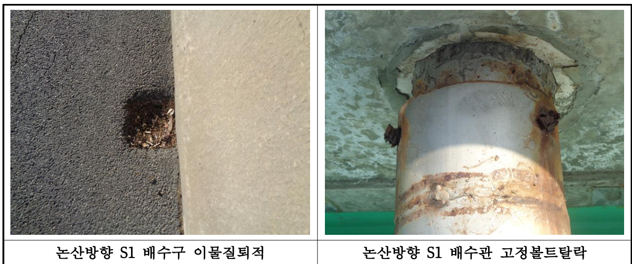
【사진 3.45】 배수관 손상현황
