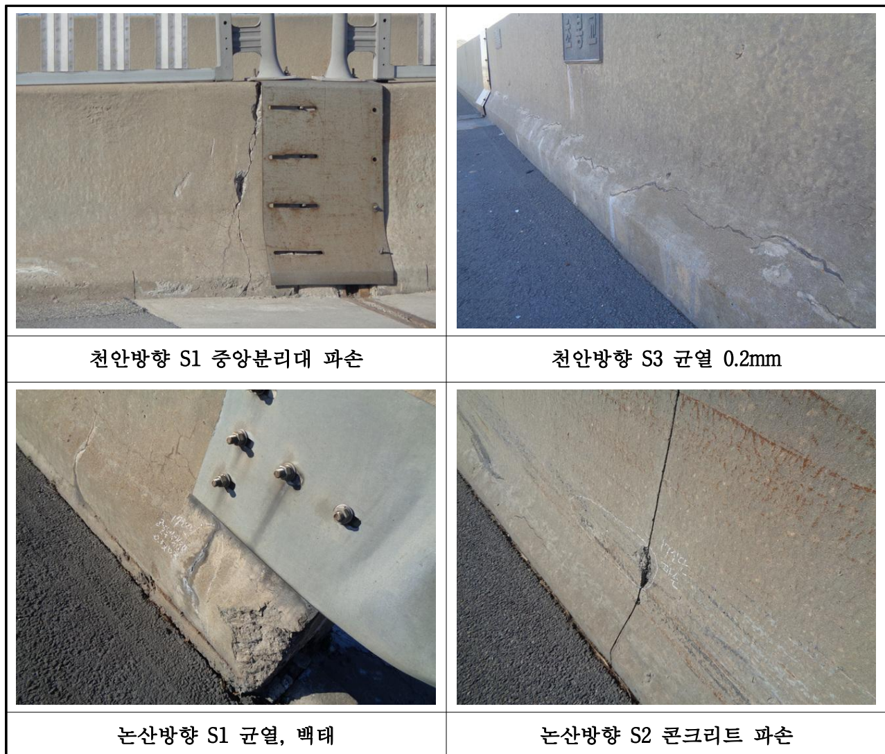
【사진 3.24】 난간 및 연석 손상현황
