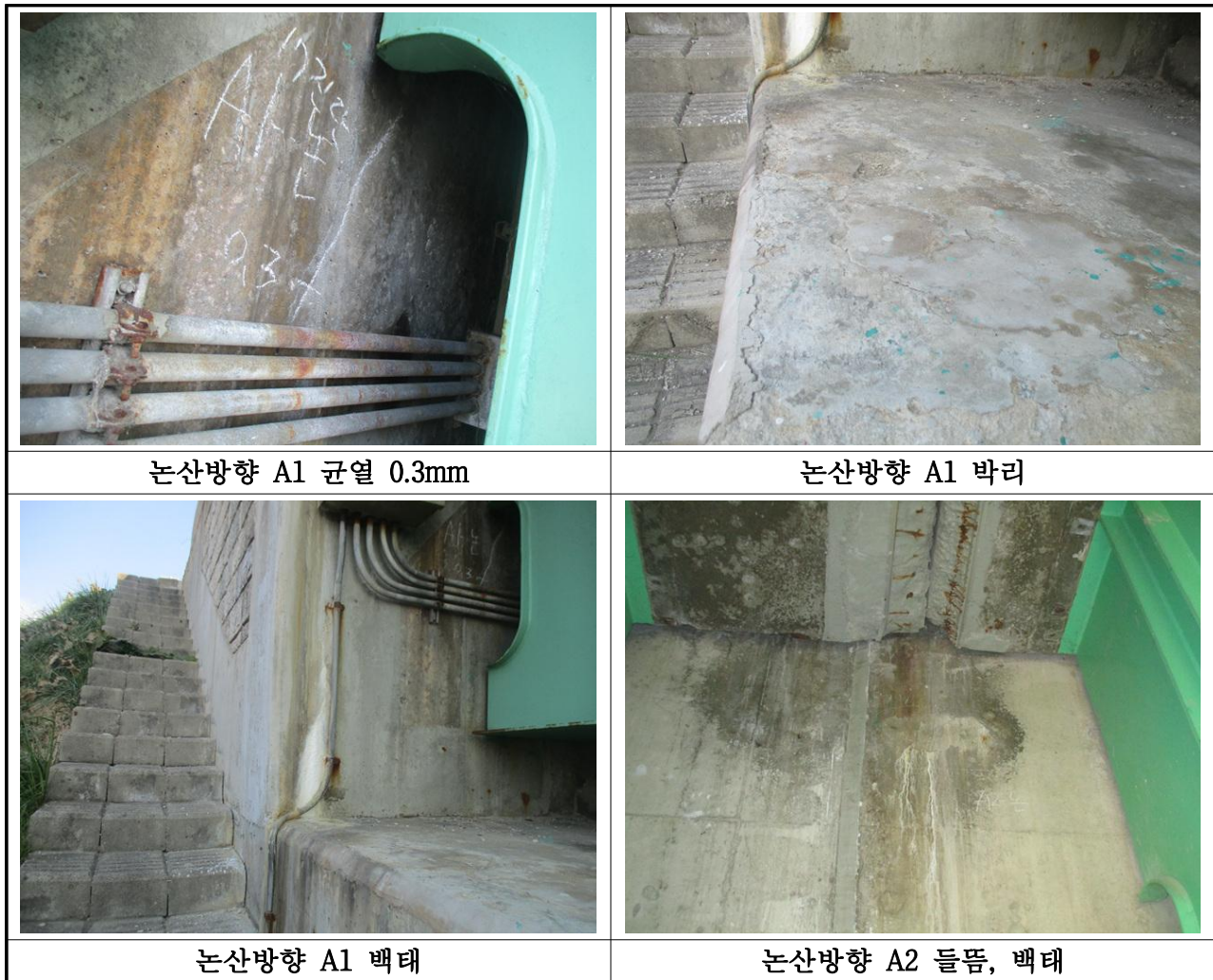
【사진 3.33】 교대 손상현황
