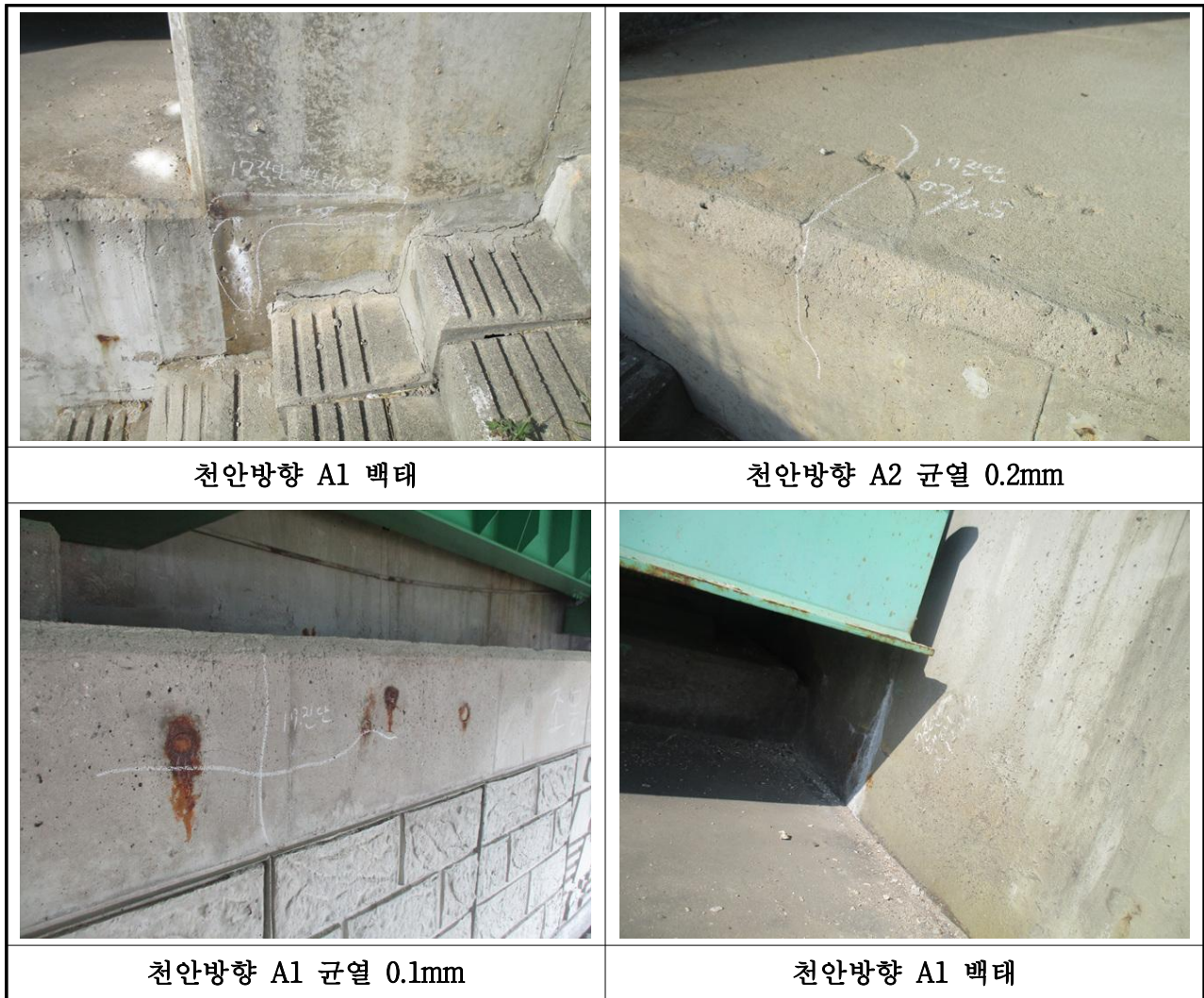
【사진 3.10】 교대 손상현황
