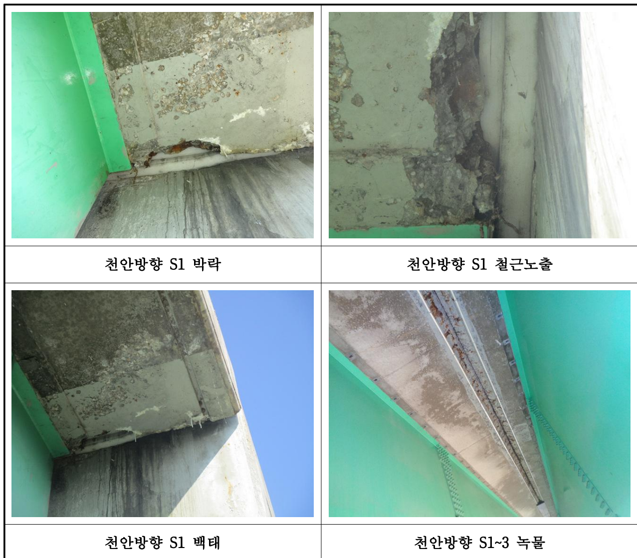
【사진 3.3】 바닥판 손상현황
