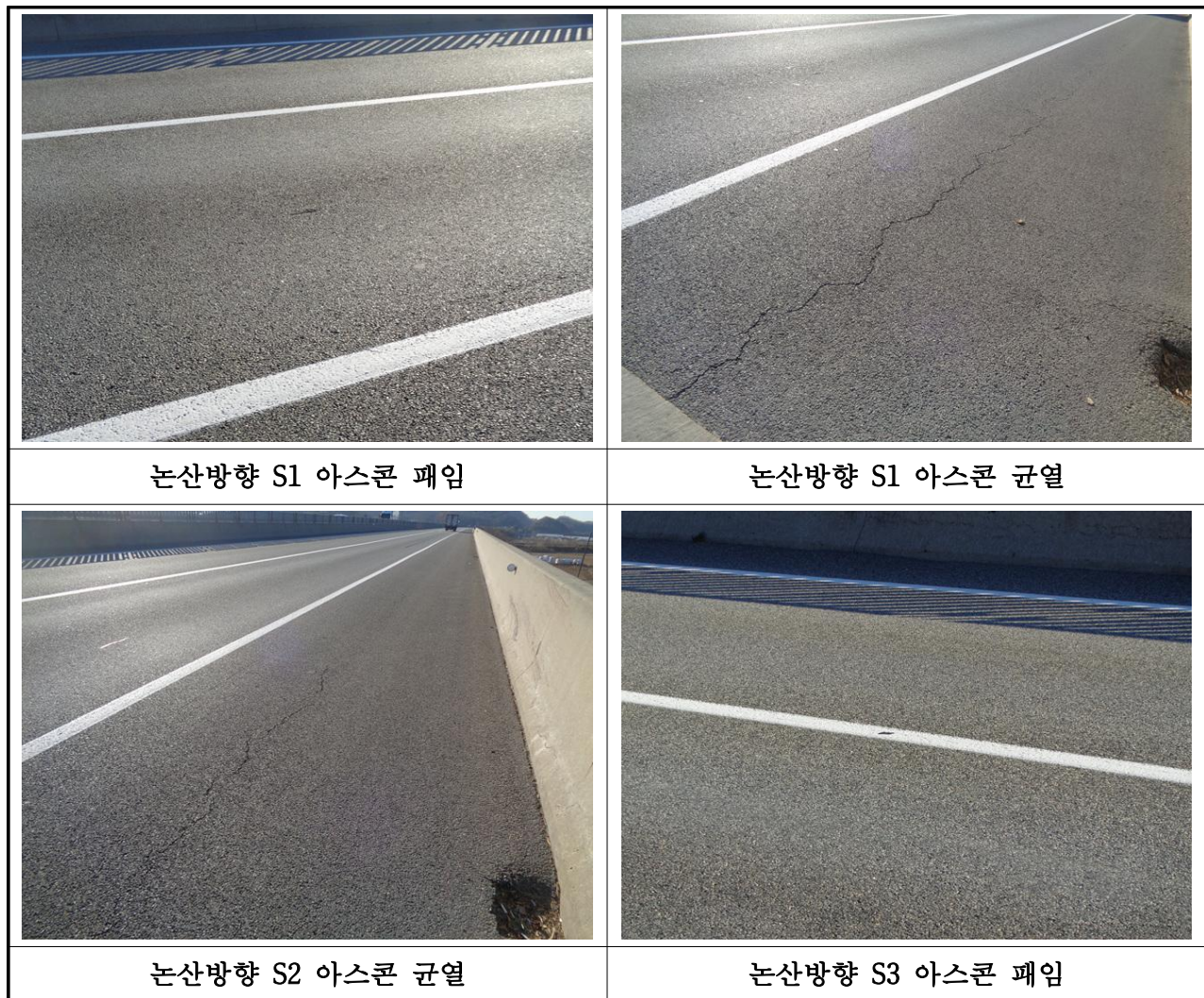
【사진 3.43】 교면포장 손상현황
