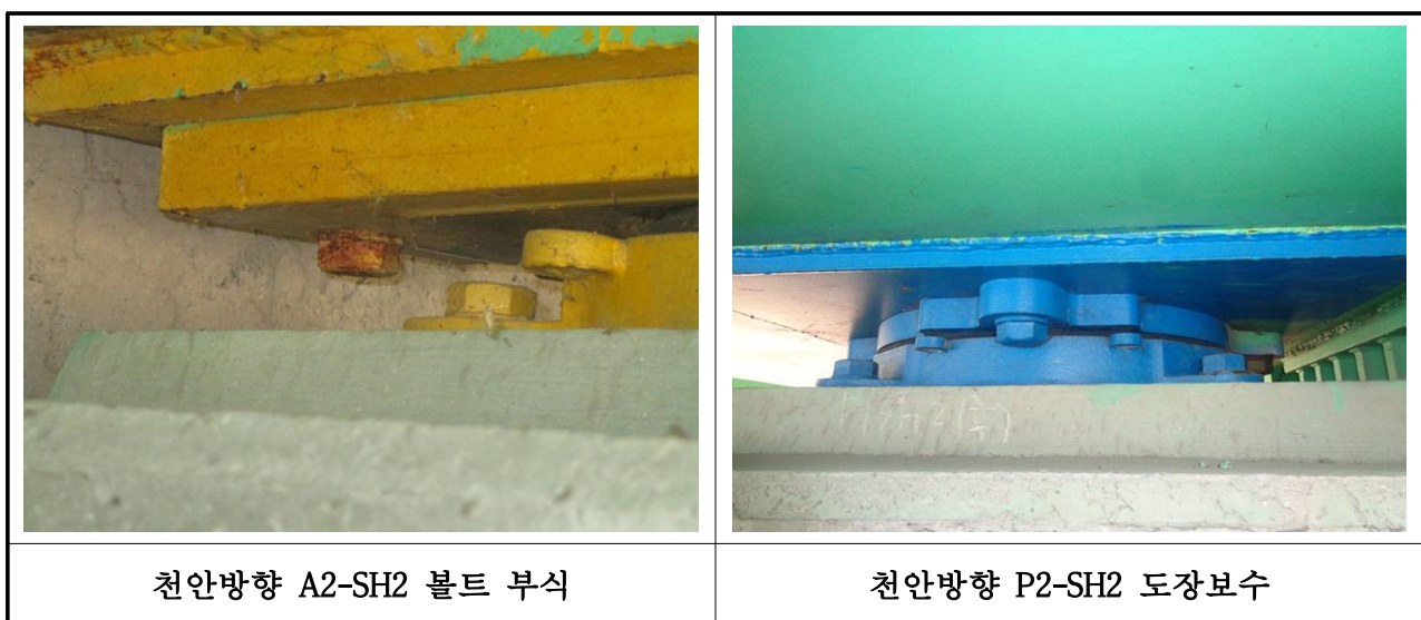
【사진 3.13】 교량받침 손상현황
